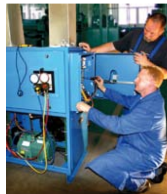
Service Schulung Servisní školení
